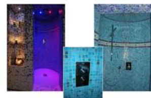
Foto DOCCE EMOZIONALI e particolare pulsantiera.
